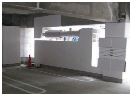
免震装置と減衰装置の設置状況
